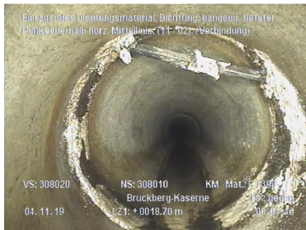
Beispiel Schadensbild Haltung
